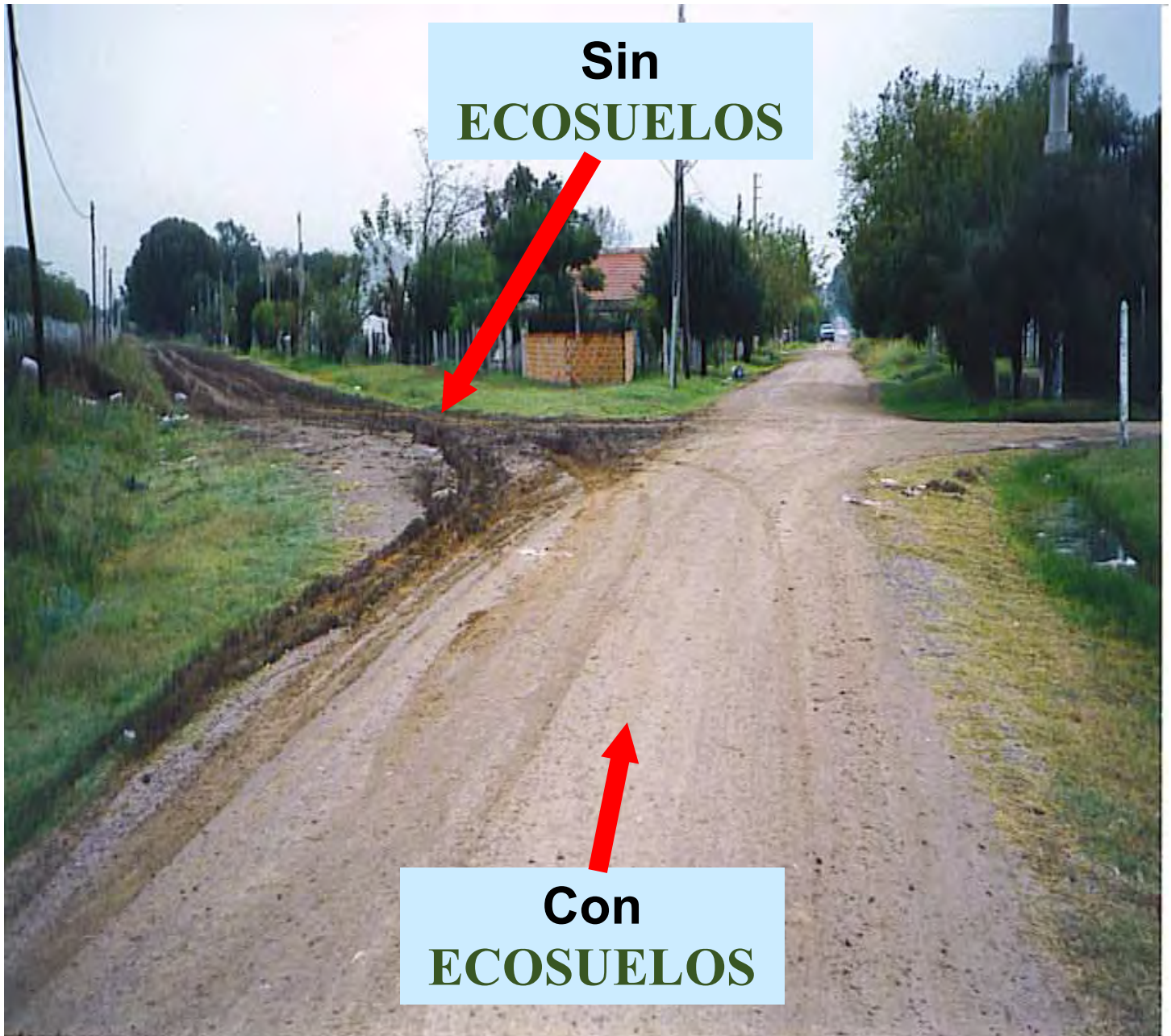
Diferencia de caminos tratados con ECOSUELOS y los revestidos en forma tradicional
